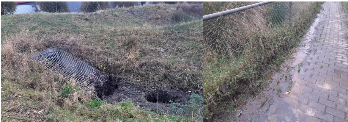
Overstort met de nodige vervuiling die wel achtergebleven is. Berm waar vervuild water richting beek stroomt
