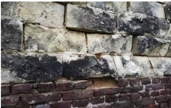
Zwaar beschadigde muur voorgevel
